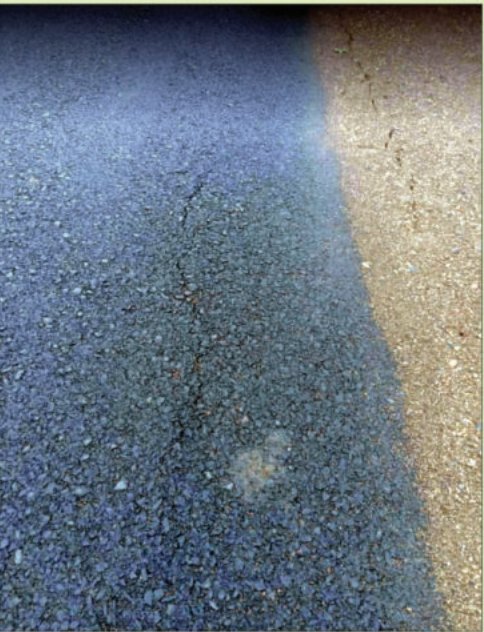
झाबुआ-रतलाम मार्ग की नव निर्मित सड़क पर डामरीकरण पर कई सवाल हैं, नया निर्माण होने के बावजूद डामर मक में भी दरारें साफ दिखाई दे रही हैं।
