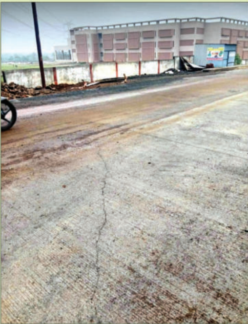
झाबुआ-रतलाम मार्ग की नव निर्मित सड़क पर कस्बों और बस स्टॉप पर बने कॉंक्रीट रोड पर भी निर्माण पूर्ण होने के पूर्व ही दिखने लगी दरारें।
